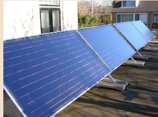
12 m 2 HR collectoren
